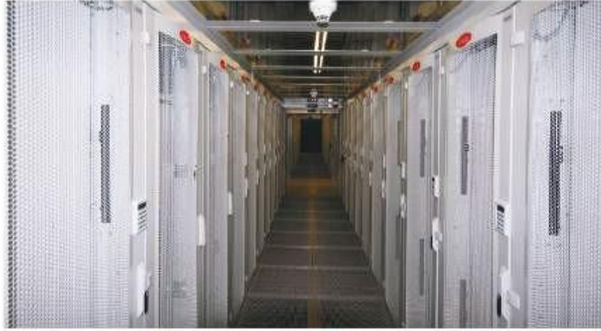
Türk Telekom IDC3 – Soğuk Koridor Uygulaması
