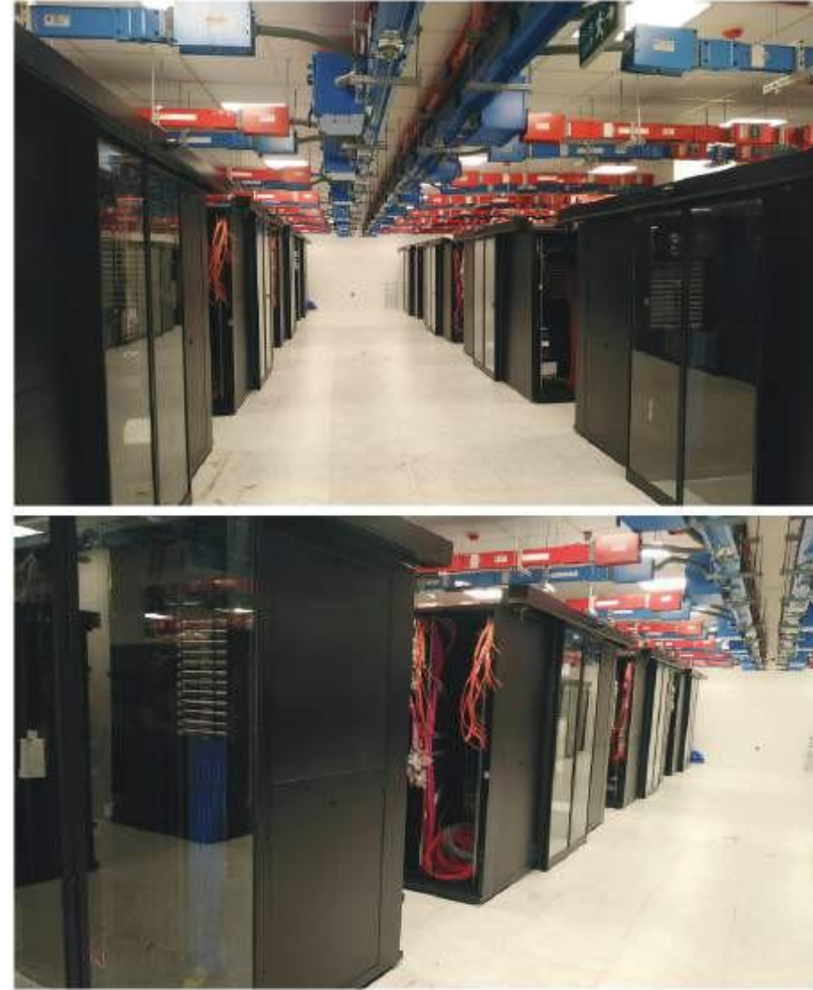
TURKSAT MACUNKOY Soğuk Koridor Uygulaması
