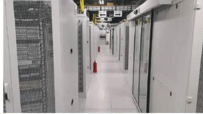
Türk Telekom IDC3 – Soğuk Koridor Uygulaması
