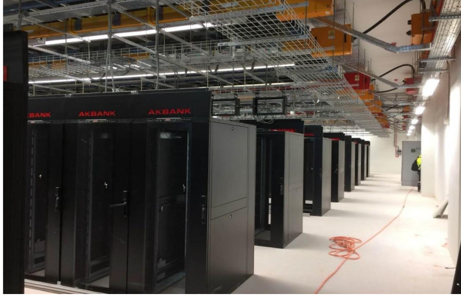
Akbank – Sıcak Koridor Uygulaması
