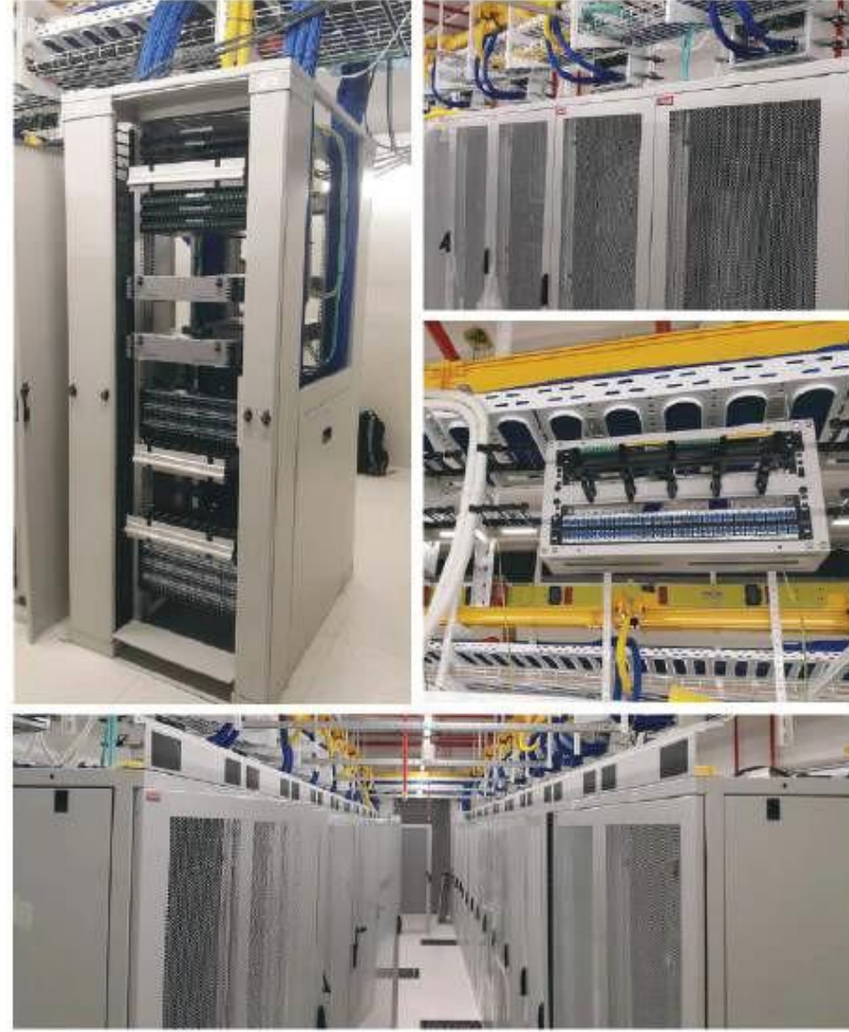
İş Bankası Tutom – Soğuk Koridor Uygulaması
