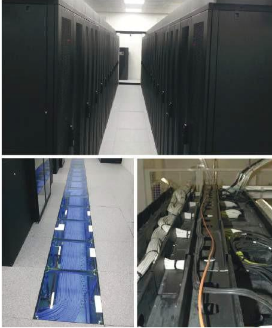
CASPER Soğuk Koridor Uygulaması
