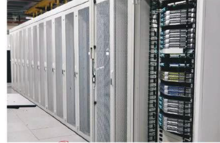
Türk Telekom IDC3 – Soğuk Koridor Uygulaması
