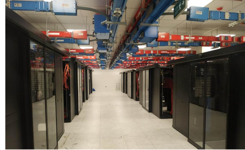
TURKSAT Macunköy Soğuk Koridor Uygulaması
