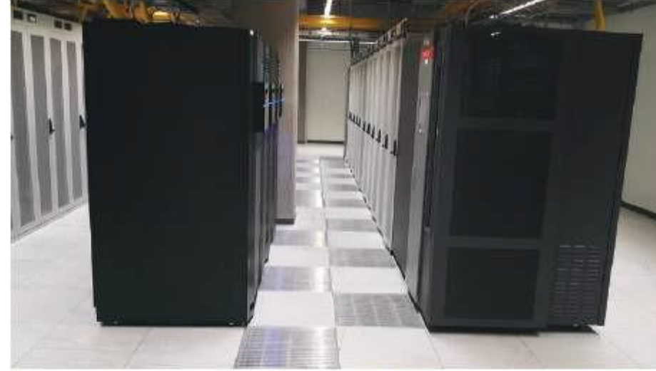
EQUINIX- Koridor Uygulaması
