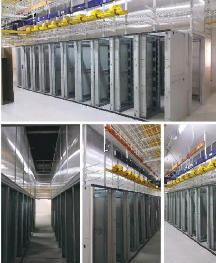
KKB Sıcak Koridor Uygulaması
