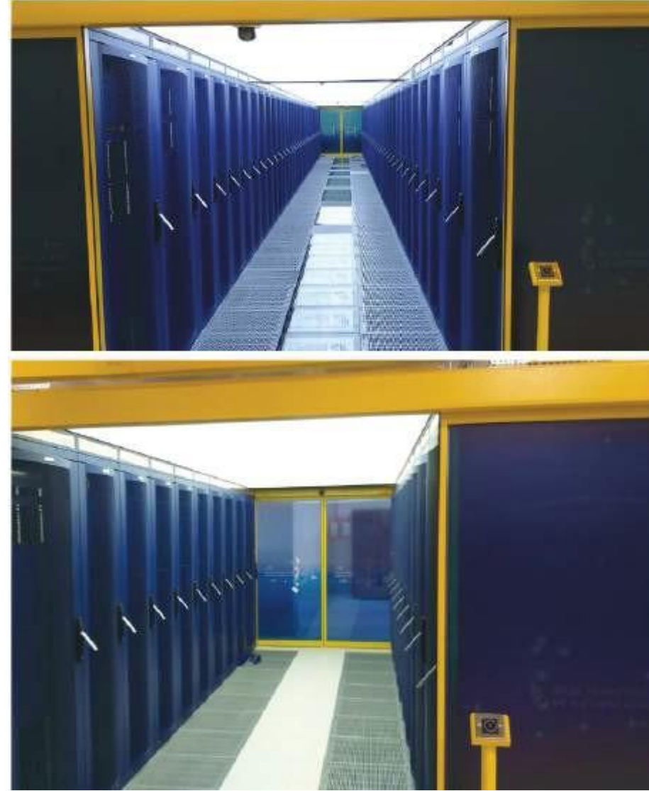
Bilgi Teknolojileri ve İletişim Kurumu (BTK) – Barrisol Soğuk Koridor Uygulaması
