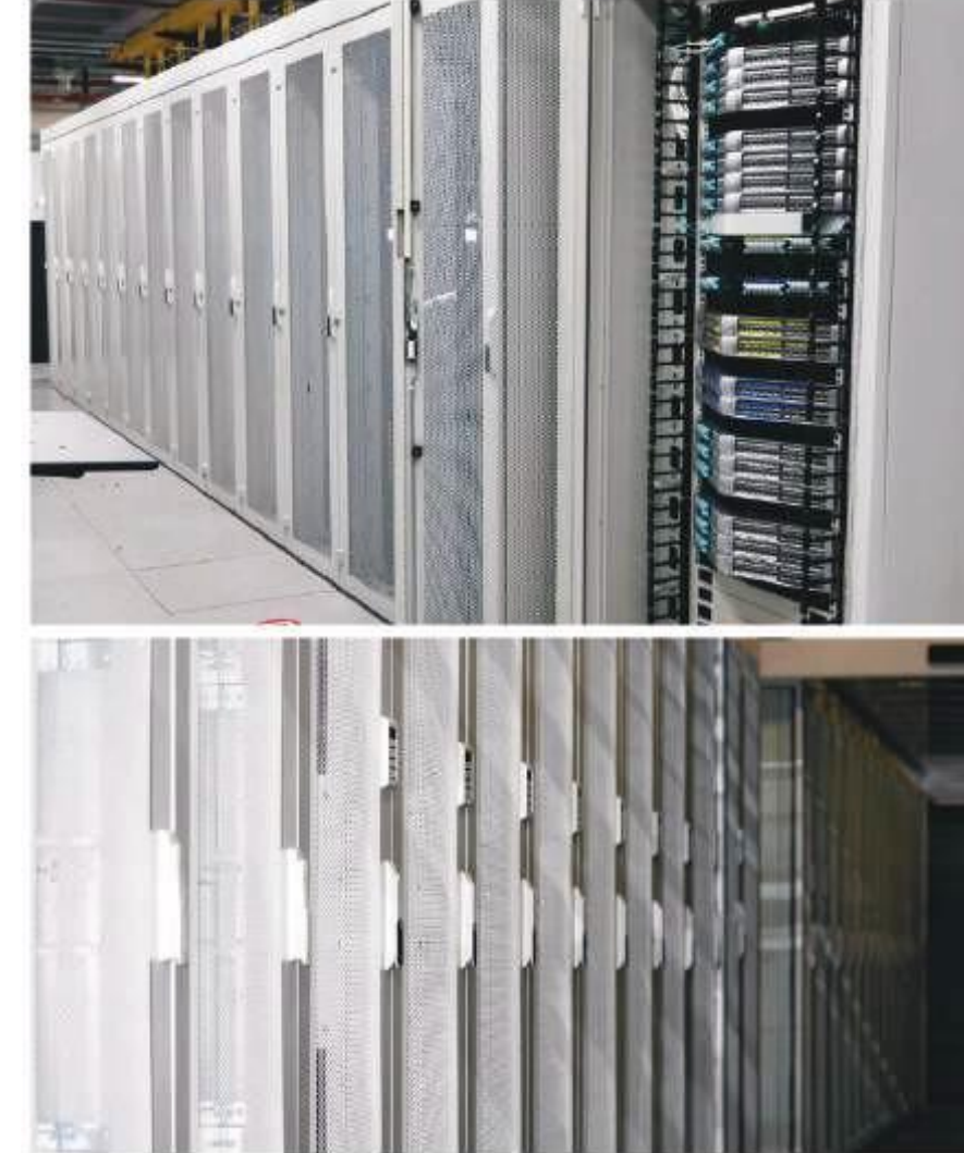
Türk Telekom IDC3 – Soğuk Koridor Uygulaması
