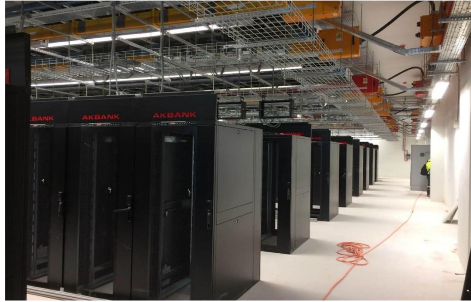
Akbank – Sıcak Koridor Uygulaması
