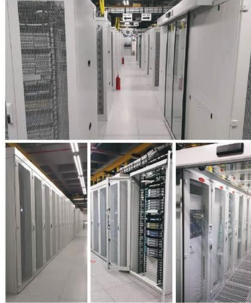
Türk Telekom IDC3 – Soğuk Koridor Uygulaması
