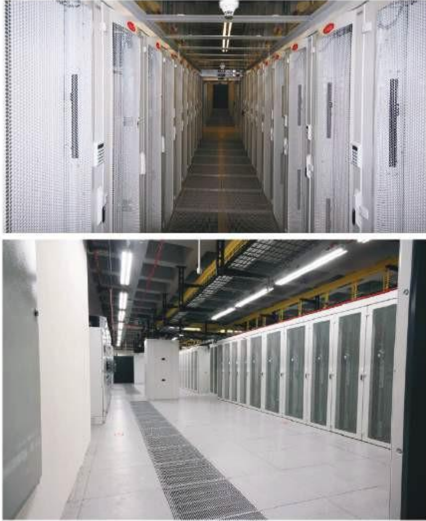
Türk Telekom IDC3 – Soğuk Koridor Uygulaması
