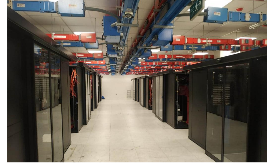
TURKSAT Macunköy Soğuk Koridor Uygulaması
