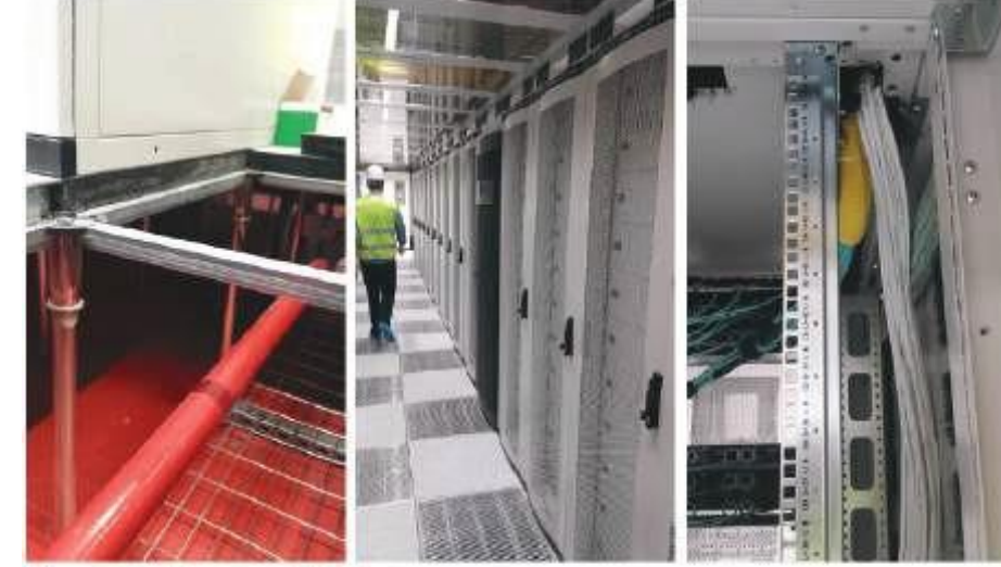
KOC SYSTEM - Soğuk Koridor Uygulaması
