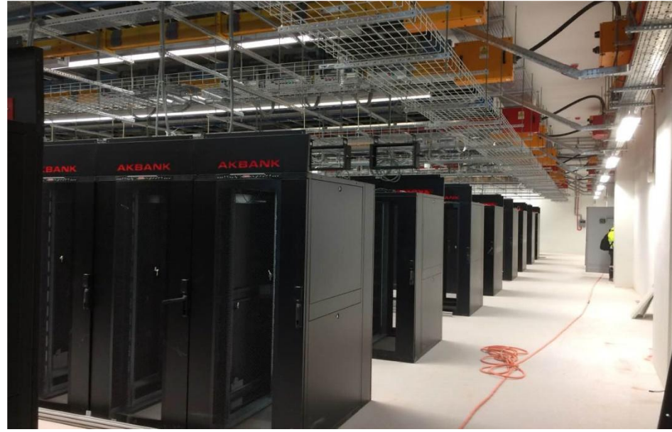
Akbank – Sıcak Koridor Uygulaması
