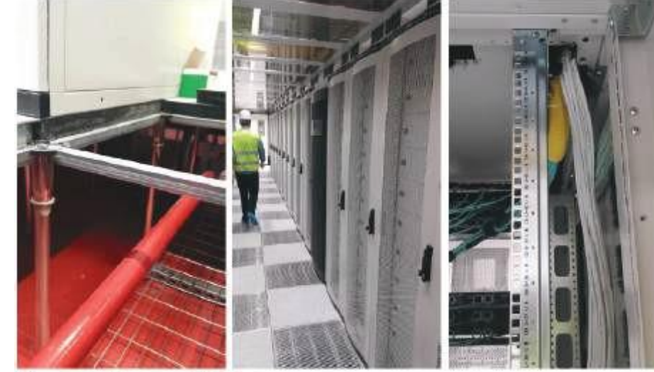
KOC SYSTEM - Soğuk Koridor Uygulaması
