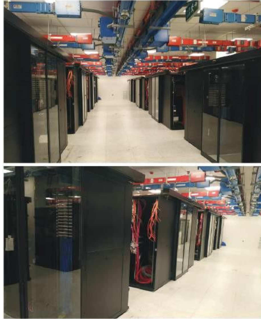
TURKSAT MACUNKOY Soğuk Koridor Uygulaması
