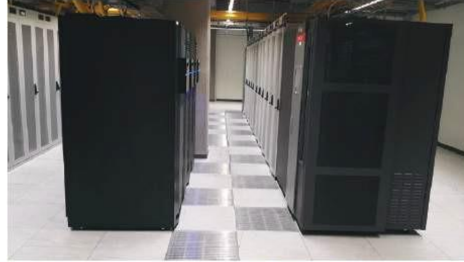
EQUINIX- Koridor Uygulaması
