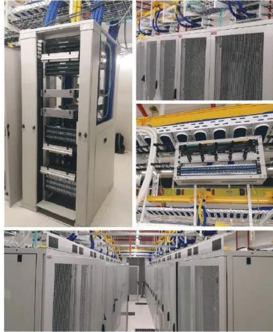
İş Bankası Tutom – Soğuk Koridor Uygulaması
